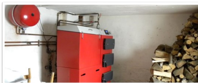
Piec C.O. w świetlicy wiejskiej w Obrowie
