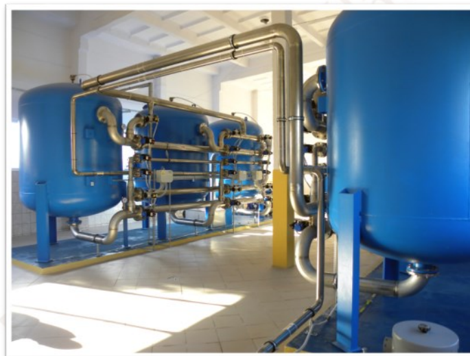
Wyposażenie hydroforni w Kęsowie
